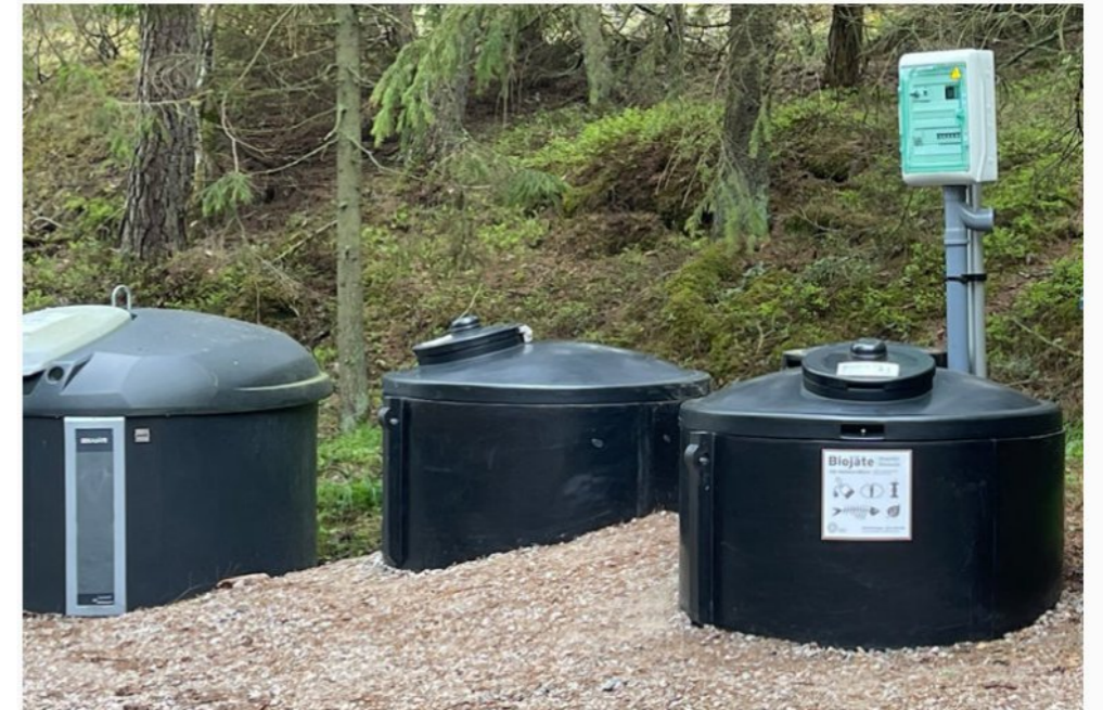
Lähteelän jäteaseman syväkompostorit. Kuva: Raita Environment Oy
